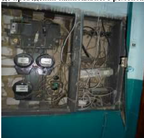
Состояние внутридомовых инженерных систем МКД до проведения капитального ремонта
