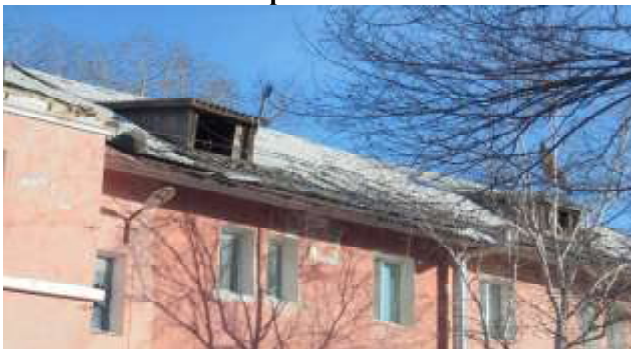
Состояние крыши МКД до проведения капитального ремонта
