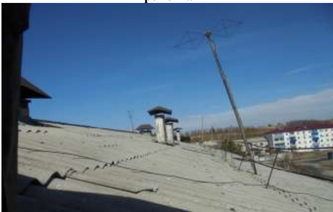
Состояние крыши МКД до проведения капитального ремонта
