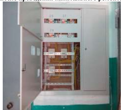
Состояние внутридомовых инженерных систем МКД после проведения капитального ремонта
